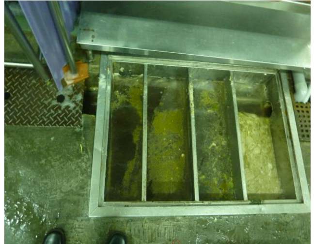
碧海營區油水分離槽運作欠佳， 放流水含大量油脂 (101 年 5 月 11 日拍攝)
