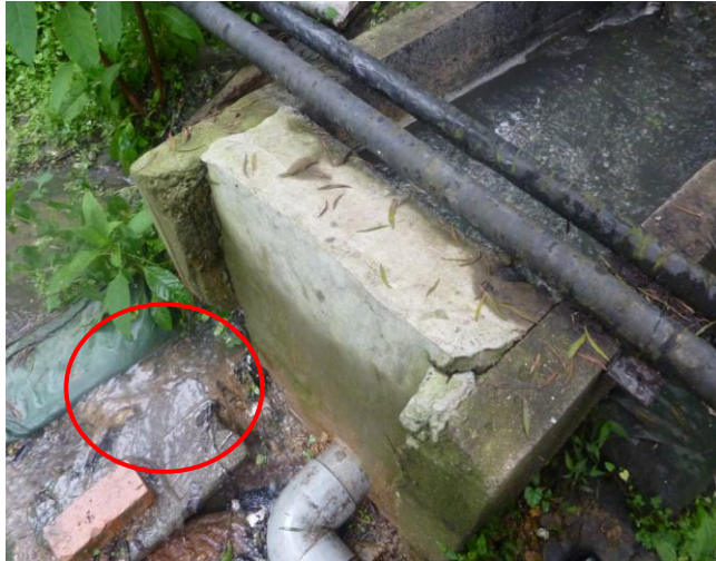
雲臺山營區污水溢出管道 (101 年 5 月 1 日拍攝)
