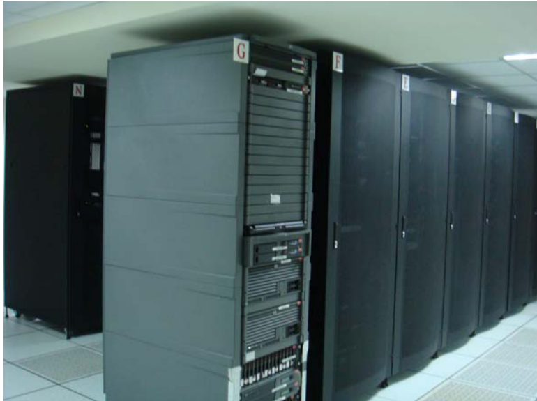
高雄市立聯合醫院資訊系統機房照片 (資料來源：高雄市政府衛生局)
