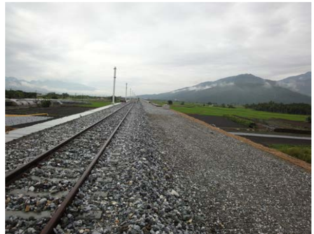
花東鐵路電氣化軌道及電桿設施 （102 年 9 月 12 日拍攝）
