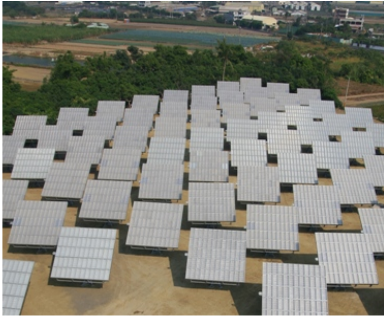
南部科學工業園區高雄(路竹)園區百萬瓦(MW)級高聚光太陽光發電系統(HCPV)示範場 (擷取自 MW 級聚光太陽光發電系統(HCPV)示範計畫期末全程成果效益報告，第 19 頁)
