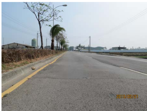
目加溜灣大道路面隆起漲裂照片 (102 年 2 月 21 日拍攝)
