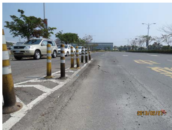
西拉雅大道路面隆起漲裂照片 (102 年 2 月 21 日拍攝)
