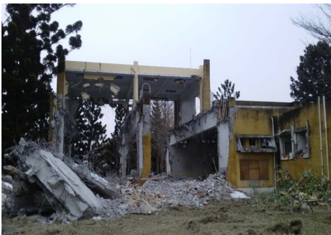
雲林縣虎尾鎮中央廣播電臺虎尾分臺 (雲林縣政府提供)
