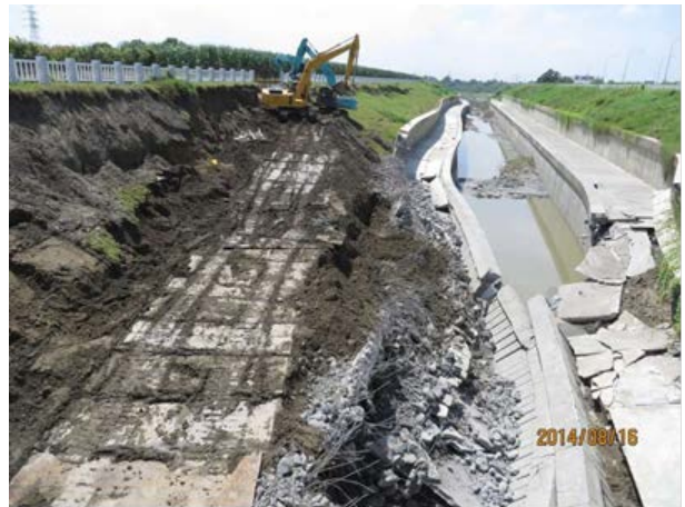
港尾溝溪疏洪工程坍塌及搶修情形 (經濟部水利署第六河川局提供)
