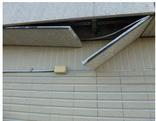
嘉義地檢辦公大樓石材斷裂情形 （嘉義地檢提供）
