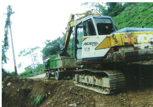
南投縣信義鄉羅娜村後山道路搶通情形 (南投縣信義鄉公所提供)
