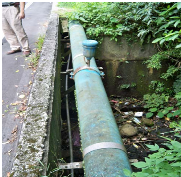
閒置未使用之前臺北縣烏來鄉供水工程 管線設備 (99 年 8 月 23 日拍攝)
