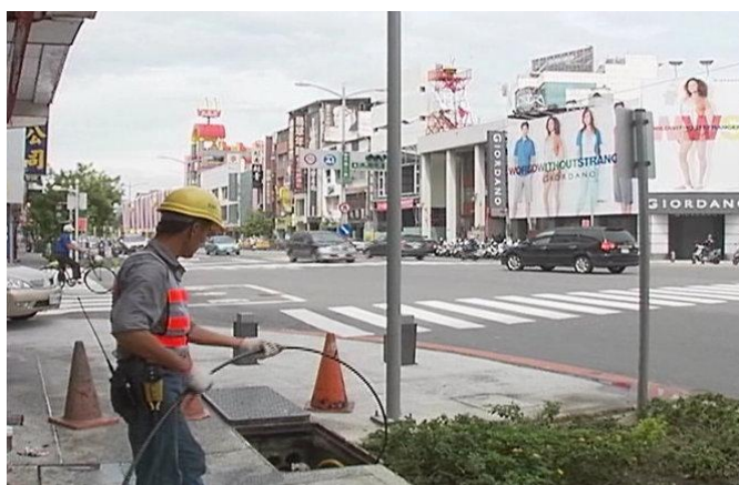
高雄市寬頻管道佈纜情形 (取自高雄市政府網站)
