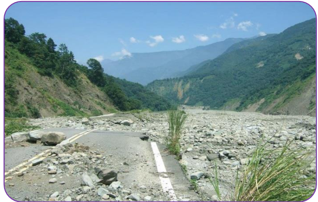
南投縣神木村聯外道路樁號K+680~1K+790處路堤護坡流失及路基毀損
