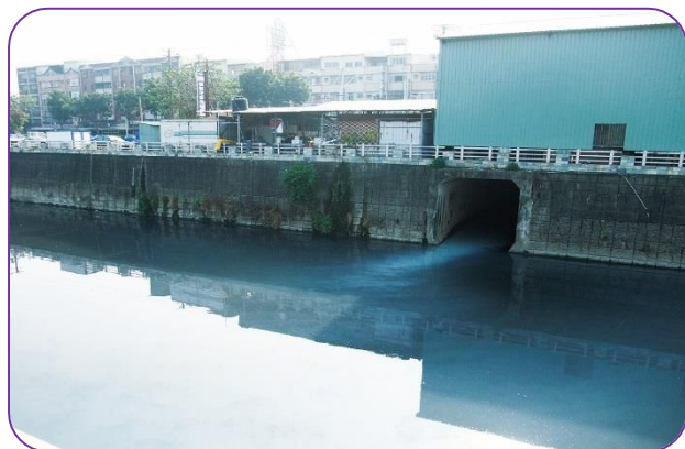
高雄市未截流污水排入鳳山溪情形
