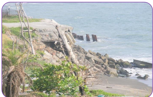
高雄市旗津海岸線侵蝕及公園設施毀損情形
