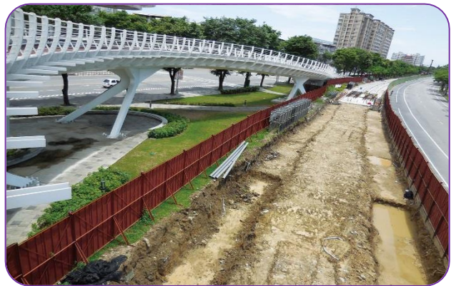
高雄市前鎮之星自行車橋結構體占據輕軌捷運部分用地
