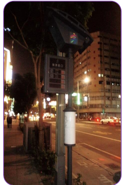
高雄市公車站牌太陽能系統失效致照明與路線顯示故障
