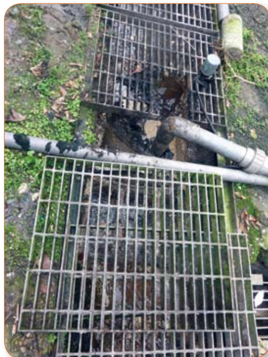
營區內污水匯流處積廢油污，污水以抽水機抽排至附近溝渠
