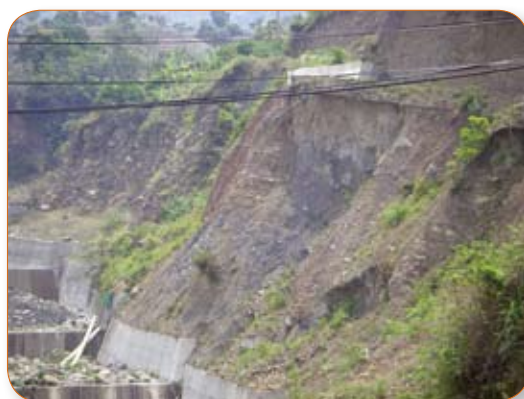
灣丘隨緣山農路邊坡崩塌
