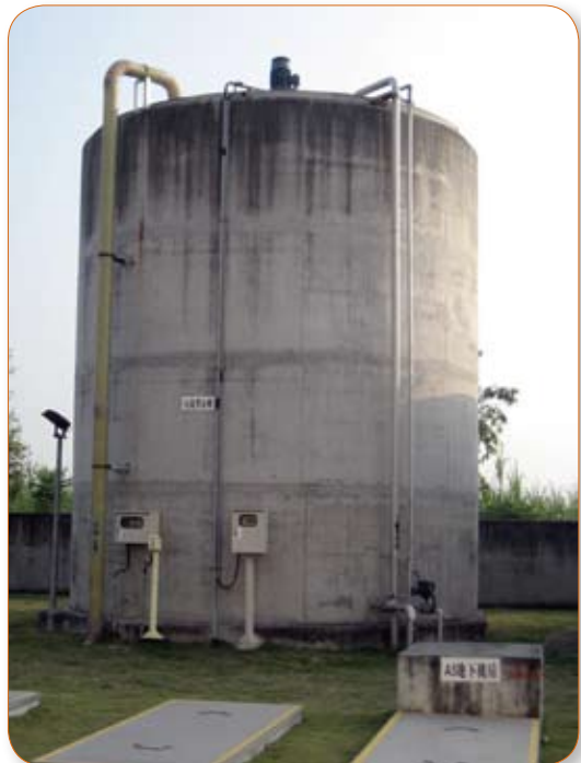
嘉義縣擴大縣治污水處理廠污泥暫存槽系統
