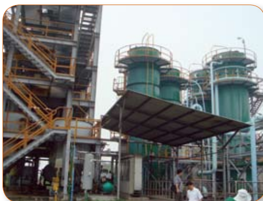
高雄市岡山本洲產業園區污水處理設施—活性碳吸附塔裝置
