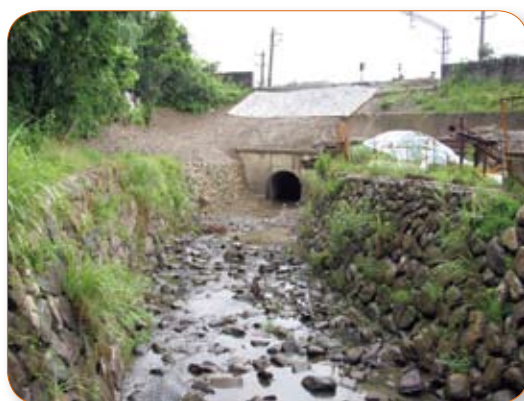
宜蘭線九份坑溪涵洞23K+200改建工程解除契約後之現況
